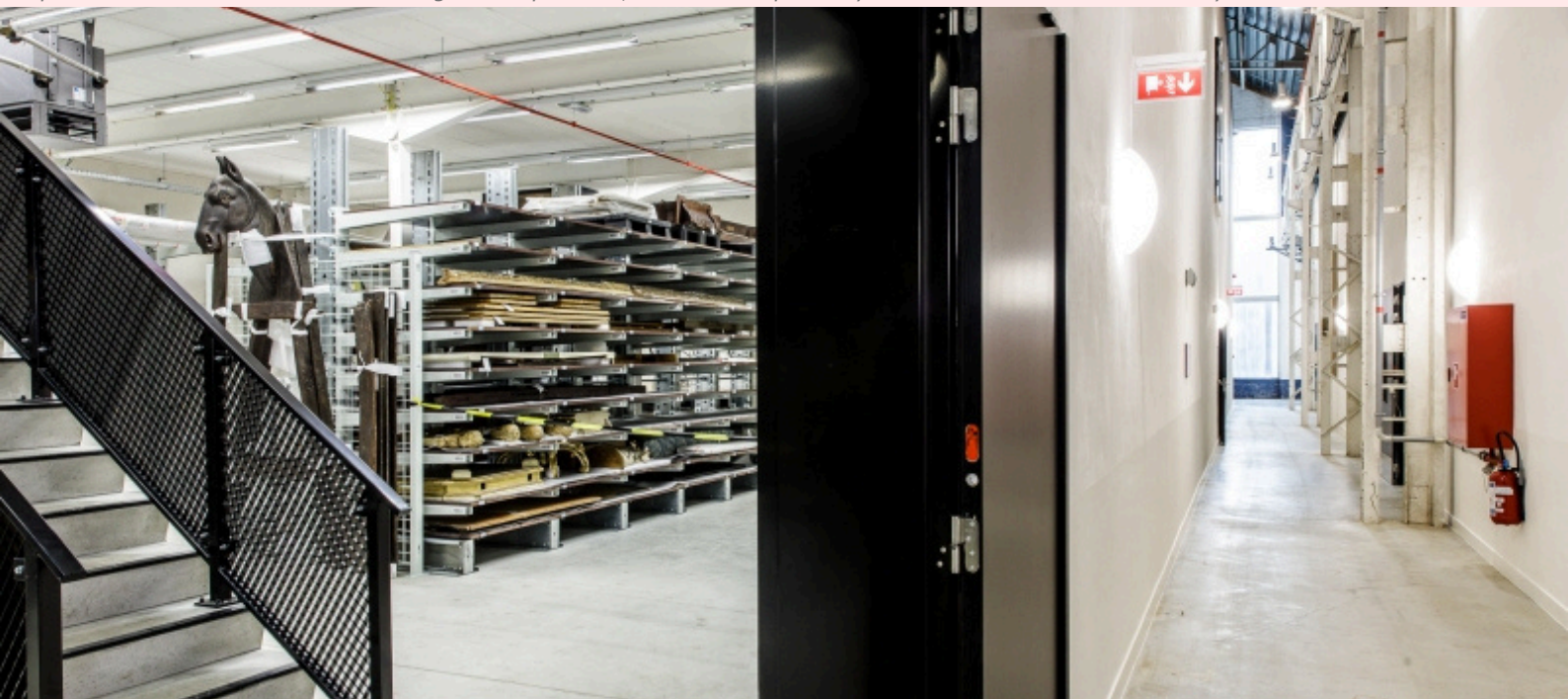
Sprinklerinstallatie en brandvoorzieningen in depot Rato, Muizen © Sophie Nuytten voor Museum Hof van Busleyden
